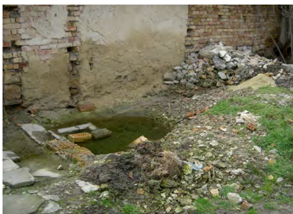
Отходна яма, пълна с отпадъчни води
