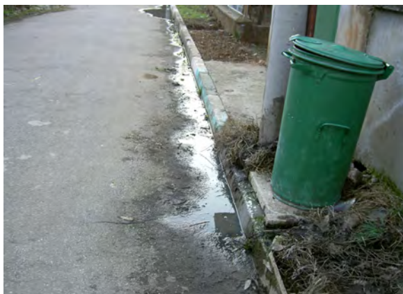
Улица, замърсена от отпадъчни води от преливащи септични резервоари
