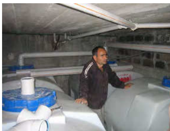
Училишен СТПУ: сутерен со резервоари за собирање, складирање и третман на урина од 350 користења
