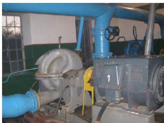
Sala motoarelor la operatorul de apă
