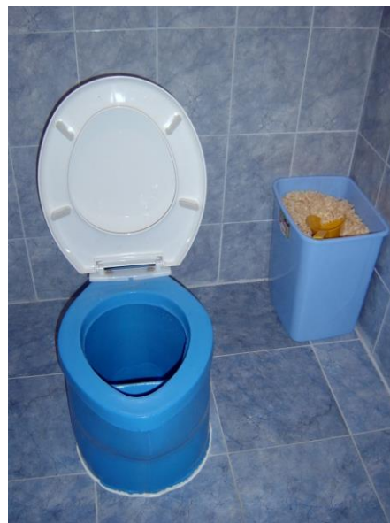
Fig. 4: Interiorul unei toalete Ecosan, Toaletă (UDDT), amplasată în interiorul unei case din Bulgaria. Foto: Earth Forever
