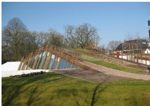
Пример экстенсивного озеленения крыши общественного здания
