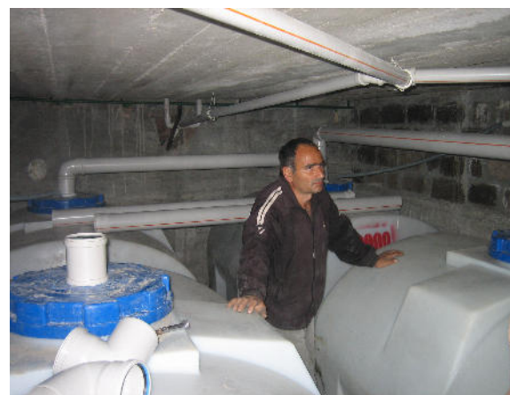
Школьный Экосан туалет: подвал с резервуарами для сбора, хранения и обработки урины
