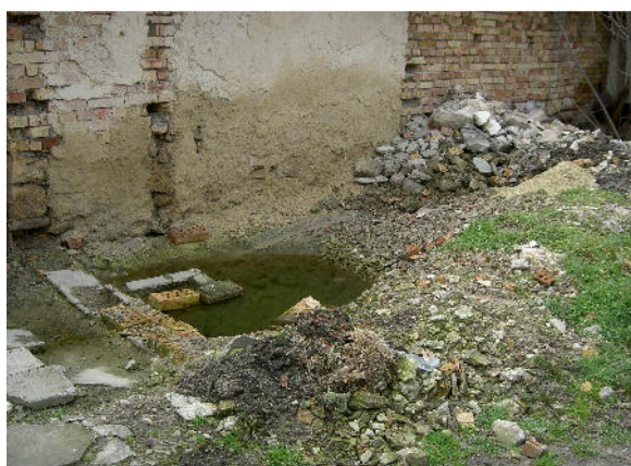
Выгребная яма, заполненная сточными водами
