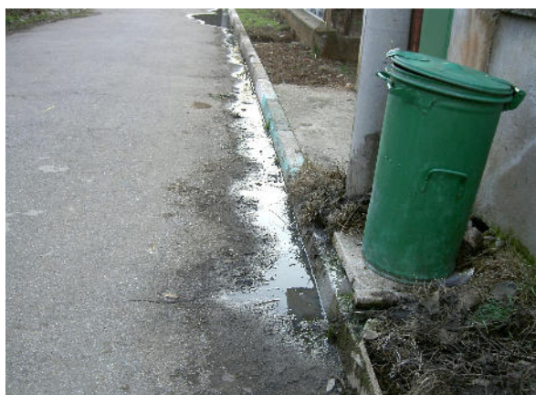
Улица, загрязняемая вытекающими сточными водами из переполненного септика
