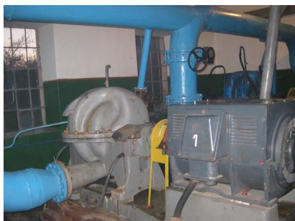
Sala motoarelor la furnizorul de apă
