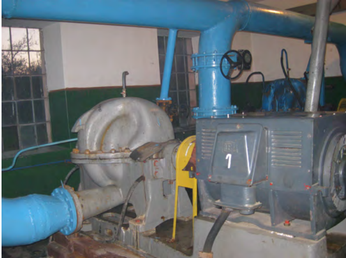
Моторот на снабдувачот на вода по поминувањето низ километри цевки
