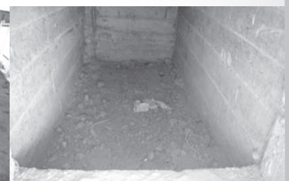
Внутри камеры для фекалий: пол покрыт слоем почвы
