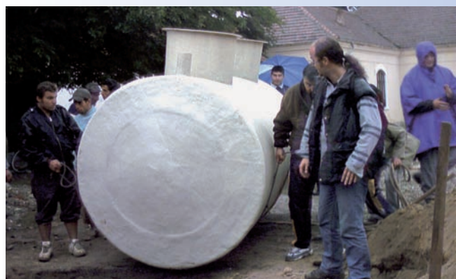
Установка на земле двухкамерного резервуара для сбора урины (изготовленного из стеклопластика)
