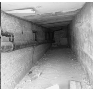
Труба для стока урины в легкодоступном для осмотра коридоре
