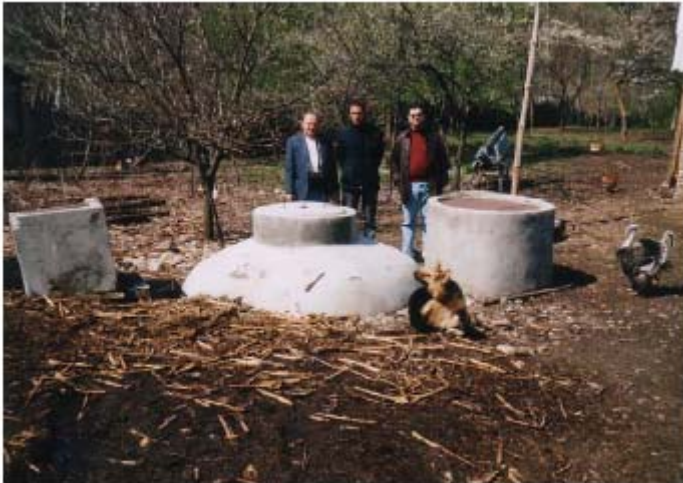
Abbildung 4a: hydraulischer Biogasreaktor in Finis, Rumänien Fig. 19 The hydraulic biogas installation in Finis.
